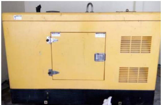
Genset Cap : 25 Kva
