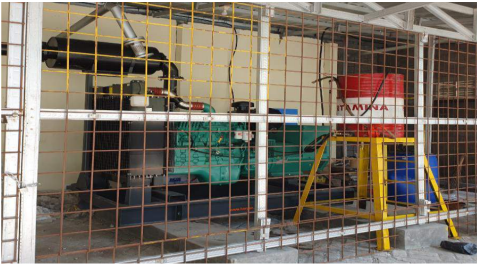
Genset Cap : 350 Kva
